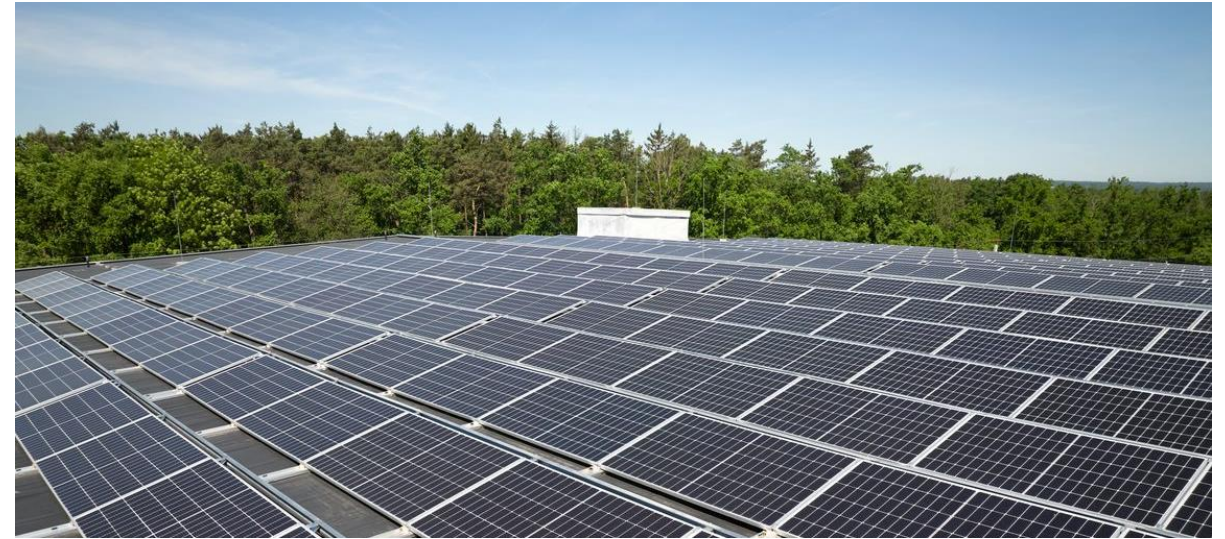
Photovoltaikanlage | Standort Kröllendorf
