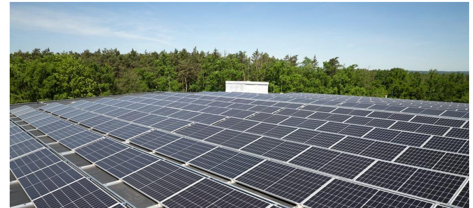
Photovoltaikanlage | Standort Kröllendorf
